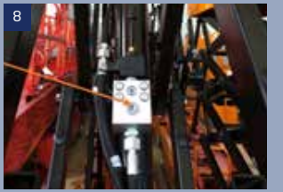
8 Explosionsgeschütztes Ventil zum Schutz vor Unfällen bei Ölaustritt
